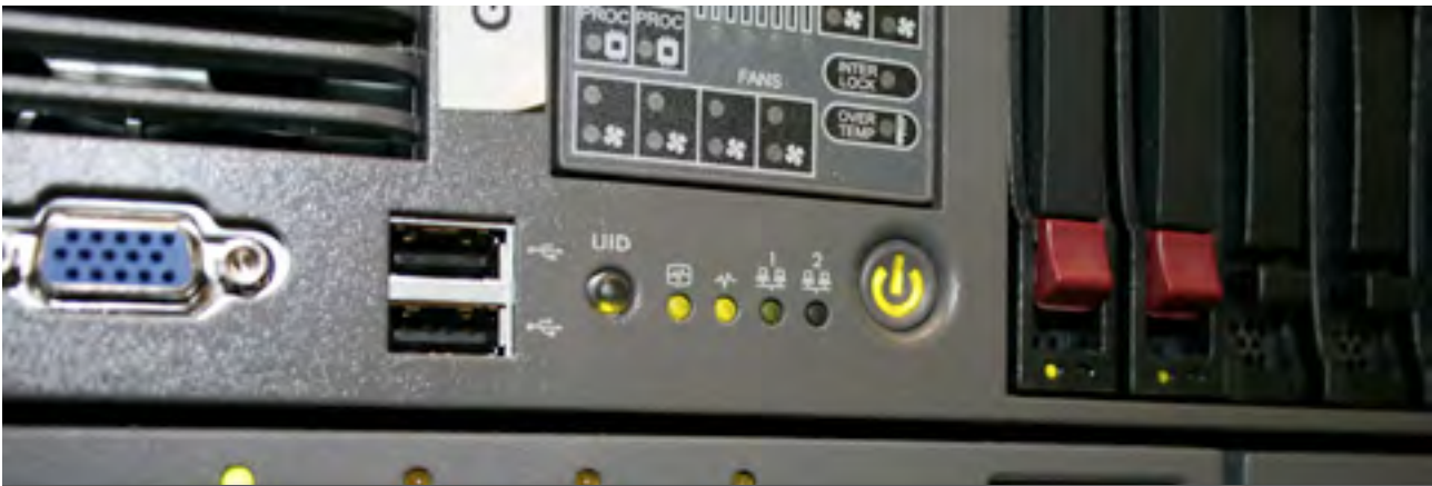
Sistema de Backup
