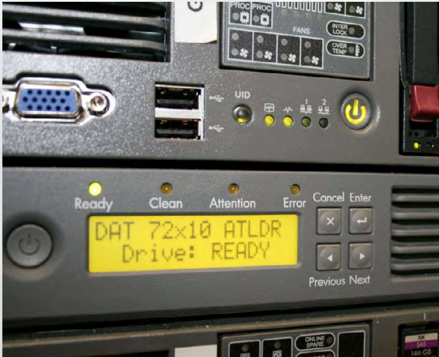
Sistema de Backup
